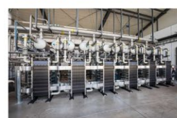
2020, 6 MW , Voestalpine, Autriche
