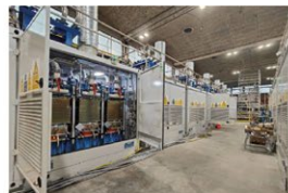
2023, 24 MW , Yara, Porsgrunn, Norvège
